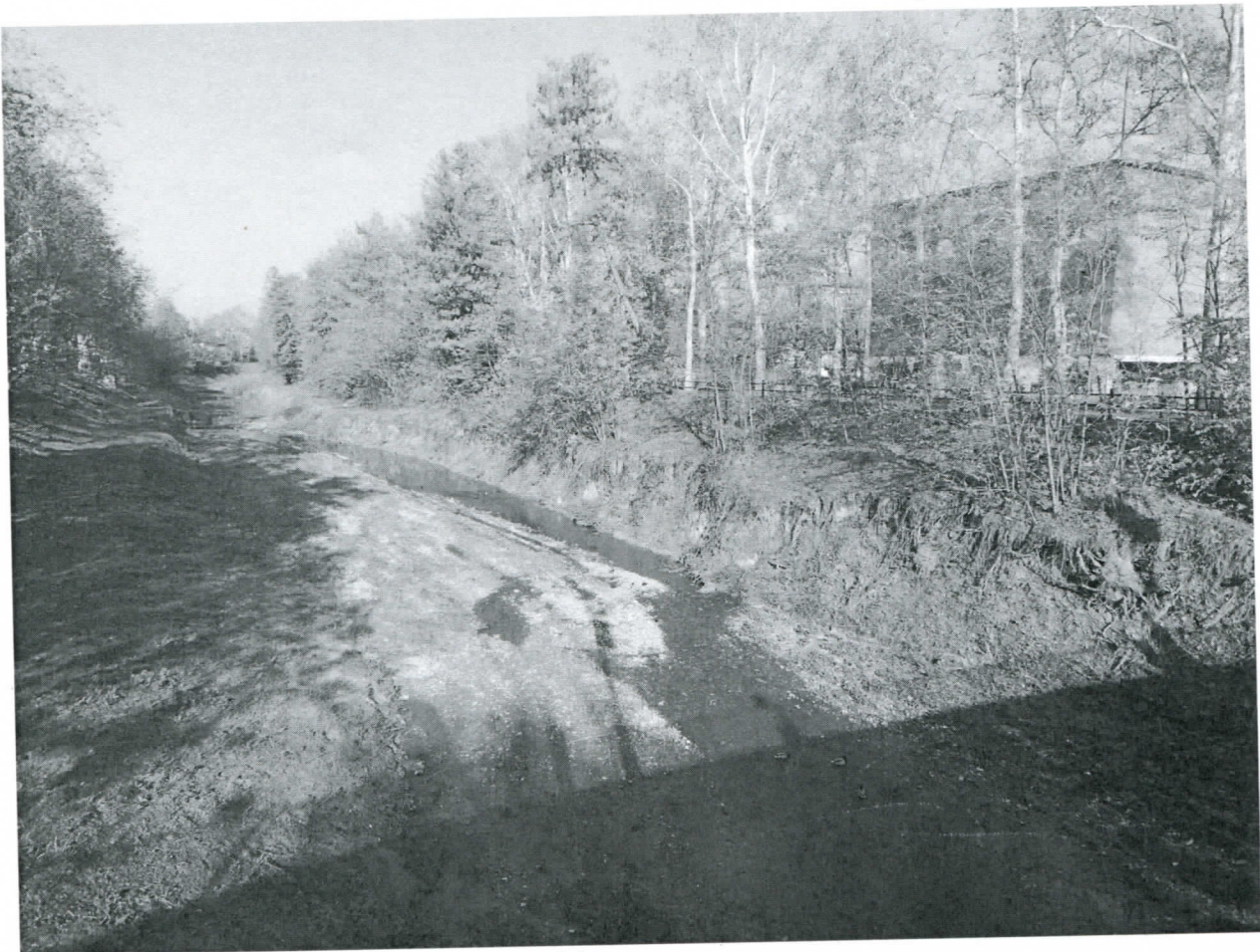
Figura 1 Torrente Crostolo, erosione argini
